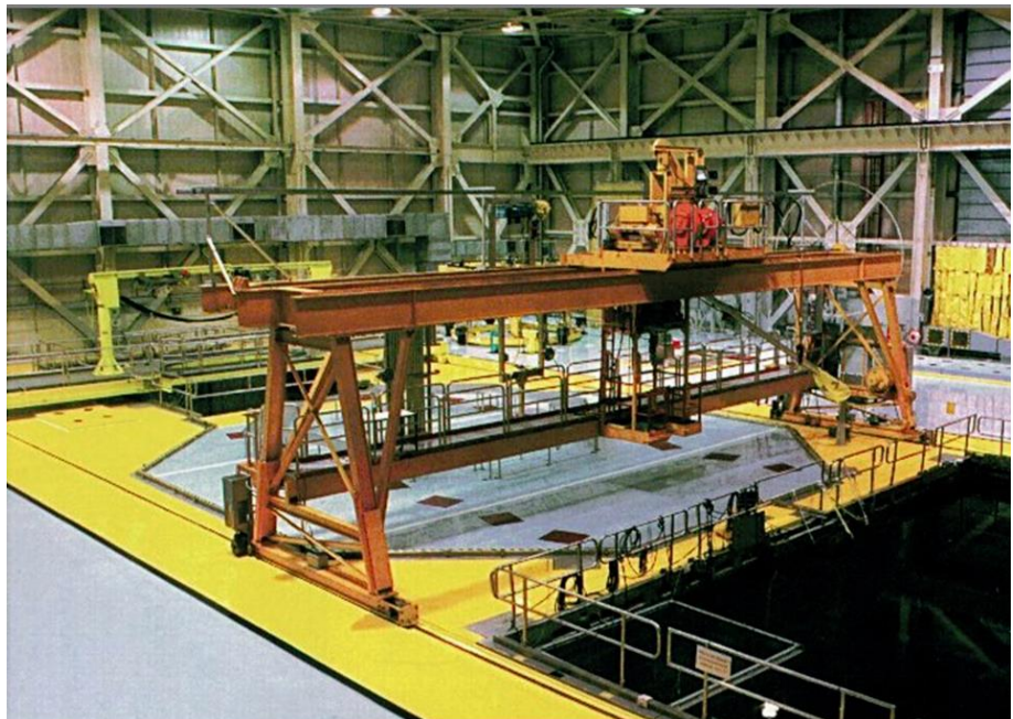
Abb. 37: Brennelementebühne im Reaktor 1
